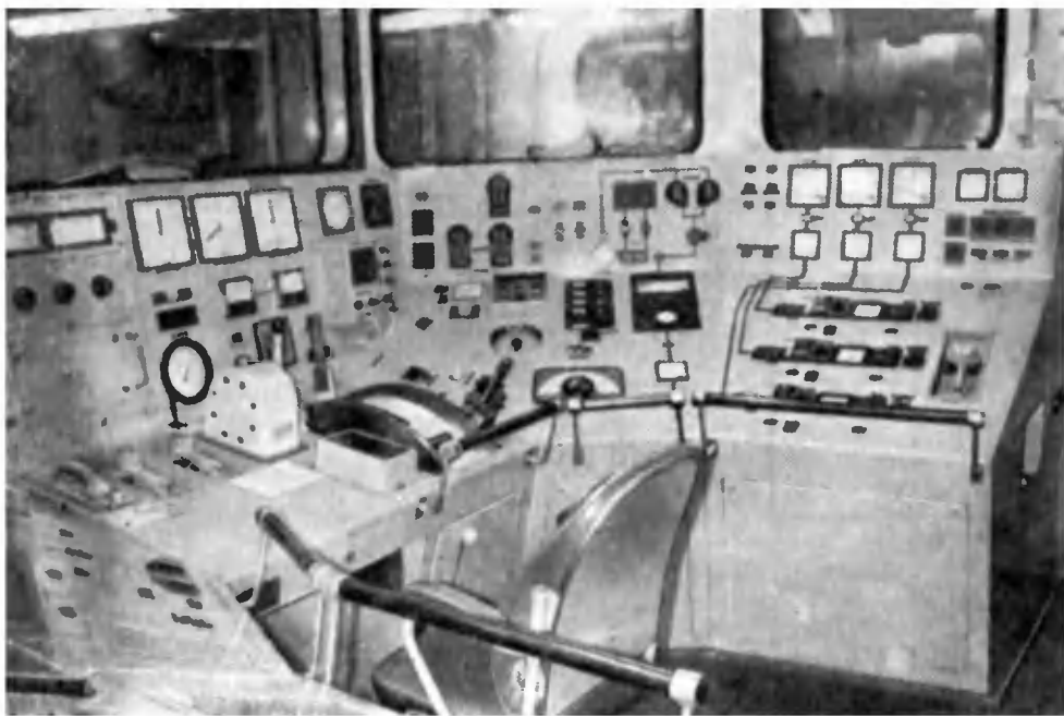
Рис. 5. Общий вид основного пульта ЦПУ теплохода «Новомиргород».
